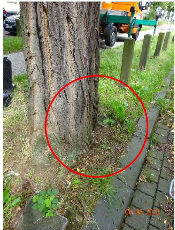
Abb. 8: Baum-Nr.138: fehlende Wurzelanläufe
